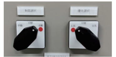
写真-2 優先電源系統の事前確認状況
